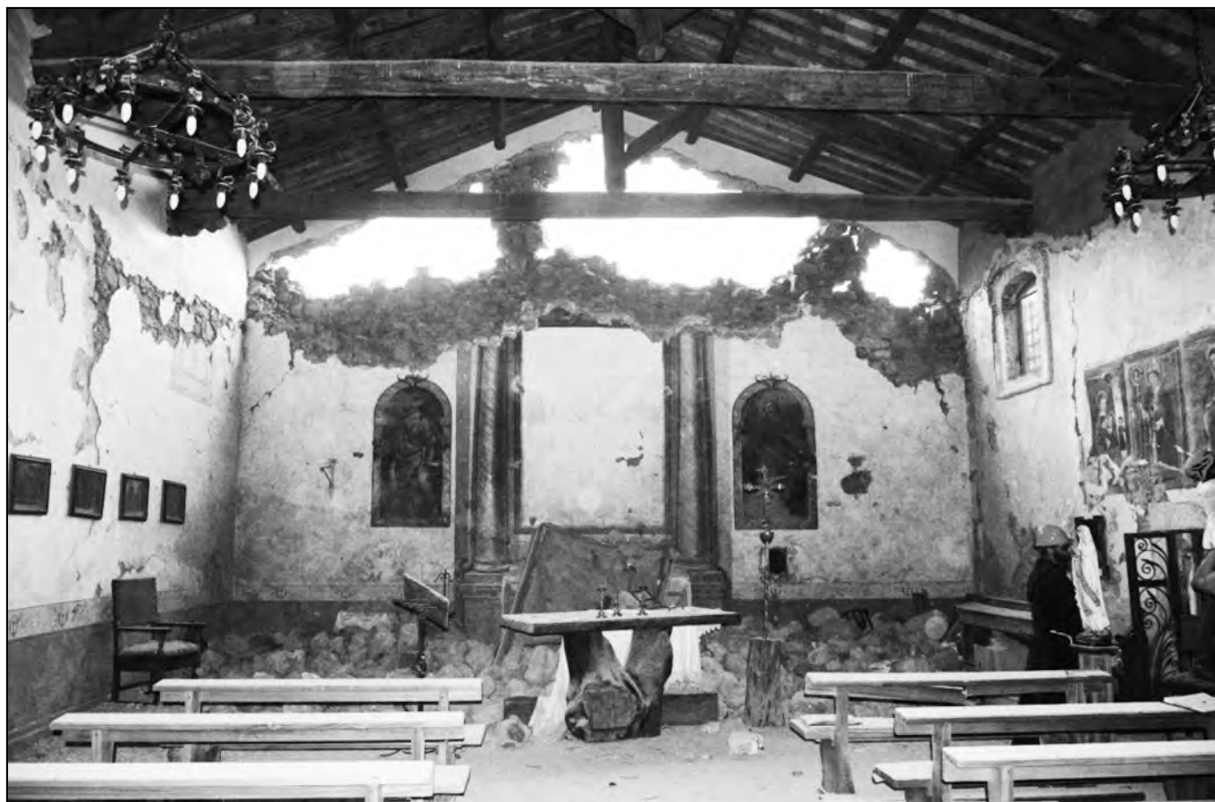
Figura 1 - Danni al muro dell'altare nella Chiesa di San Martino (Moletano, Amatrice) dopo il primo evento sismico del 24 Agosto 2016 [foto Diana L.]
