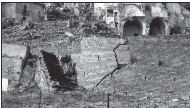
Figura 4 - I resti del muro di sostegno costruito nel 1888.
